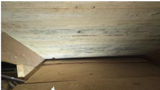
Exempelbild, mikrobiell påväxt underlagstak.
