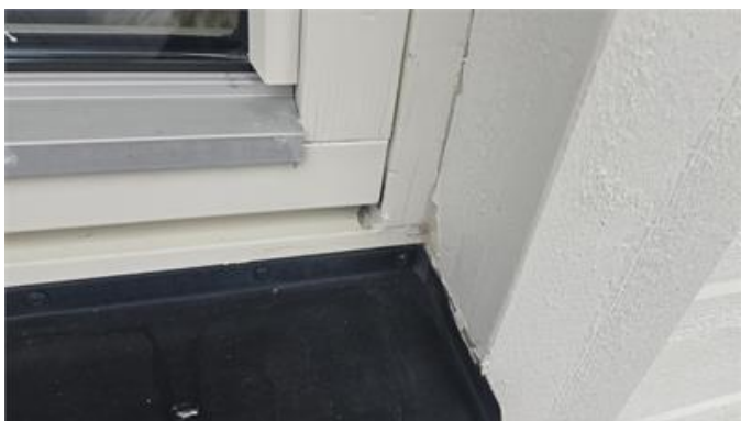
Exempelbild, målning/underhållsbehov fönster.
