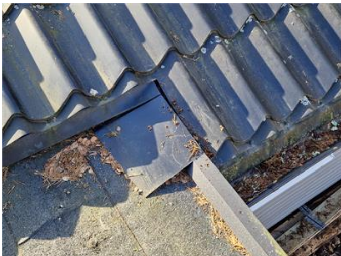
Tak (sadeltak): Glipa noterades mellan plåtdetaljer.
