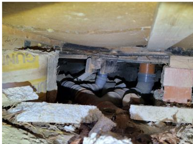
Plintgrund: Fuktfläckar och rötskador noterades i bjälklag under våtrum.
