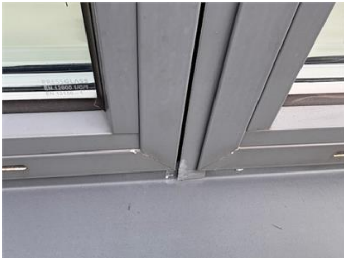
Bilden visar exempel på otätheter/brister vid/med plåtdetalj.
