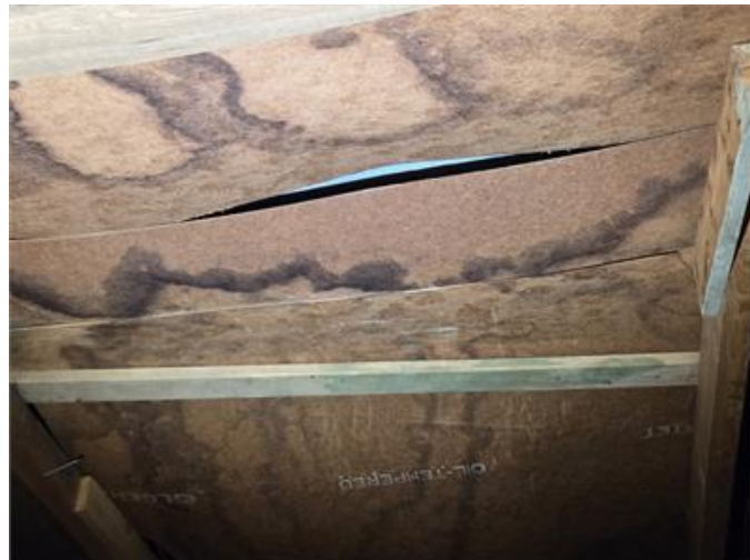
Fuktfläckar på underlagstak
