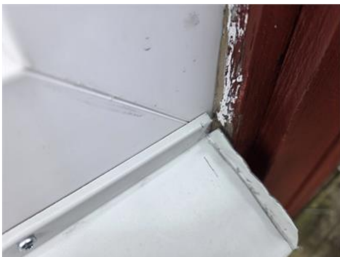
Fönsterbleck med åtgärdsbehov.
