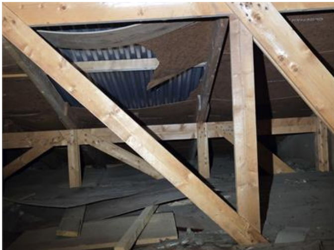
Underlagstak har släppt från sin infästning
