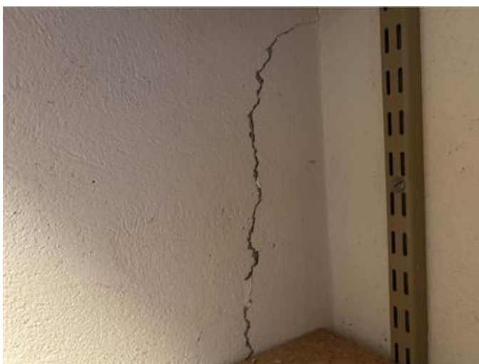
Källare: Sprickor förekommer.
