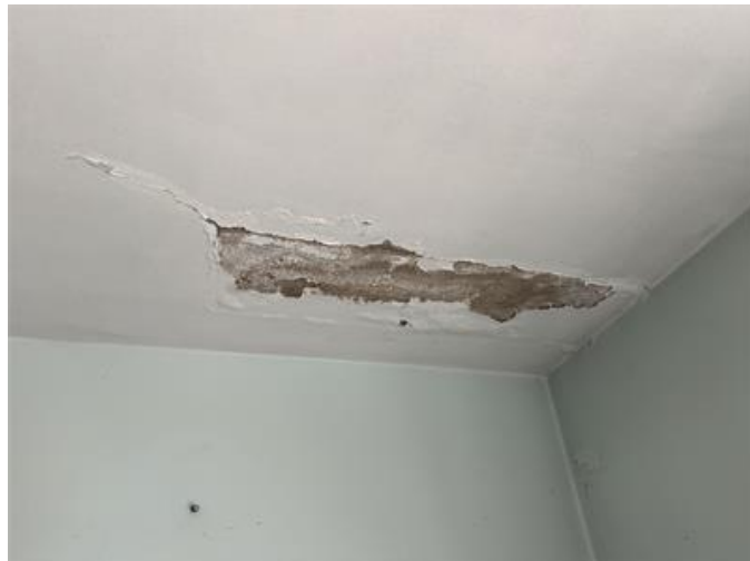
Källare: Färgsläpp från gammal vattenskada enligt uppgift.
