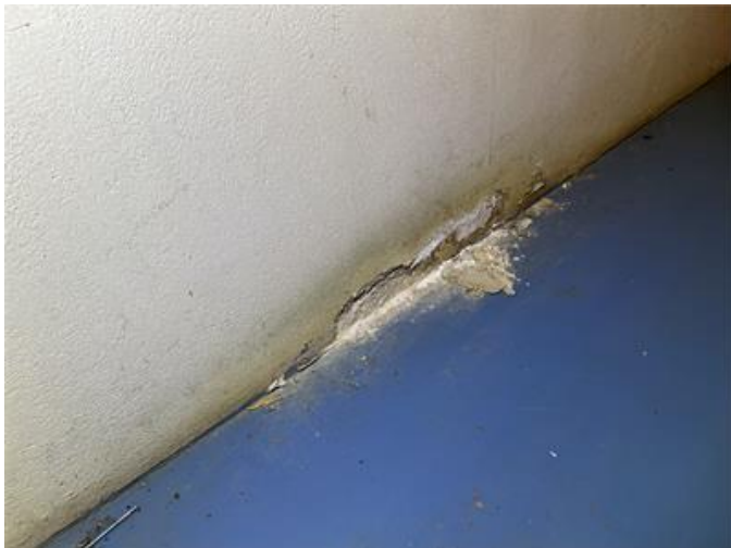
Källare: Färgsläpp och mineralutfällningar noteras på flera ställen.
