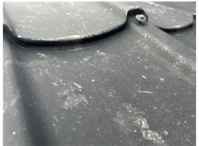
Tak: Otätheter i infästningar och bucklor förekommer.
