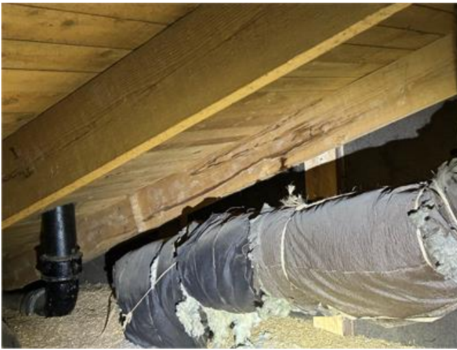
Nockvind norr: Fuktanvisningar förekommer på flera ställen.
