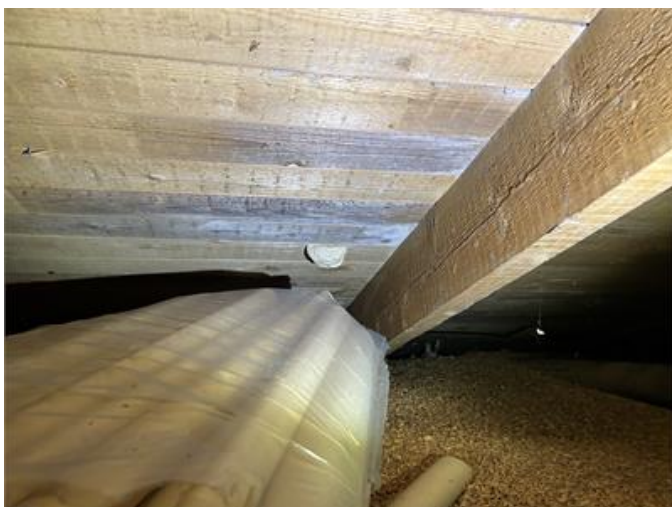
Nockvind söder: Mikrobiell påväxt noteras på underlagstaket.
