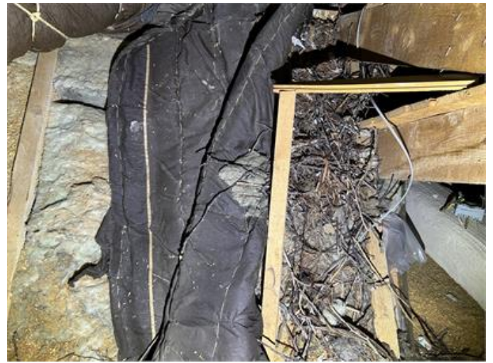
Nockvind norr: Fågelbo noterades vid besiktningstillfället.
