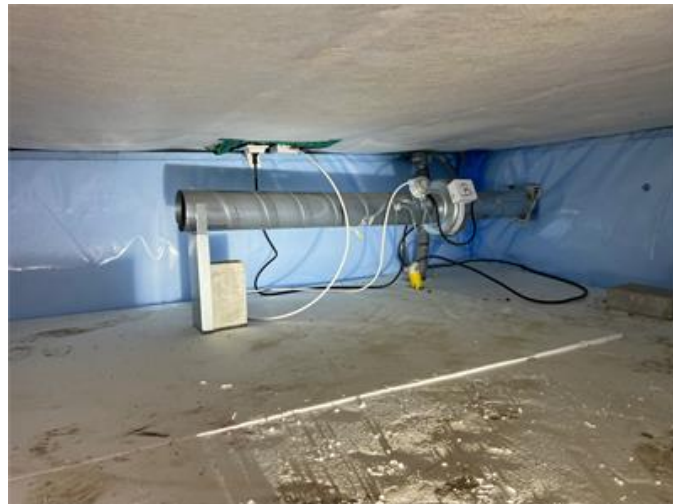
Installation som har till uppgift att verka för ett torrare klimat i krypgrunden.
