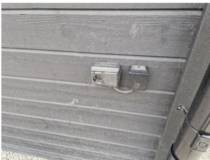
Fasad: Lock saknas på eluttag på fasad.
