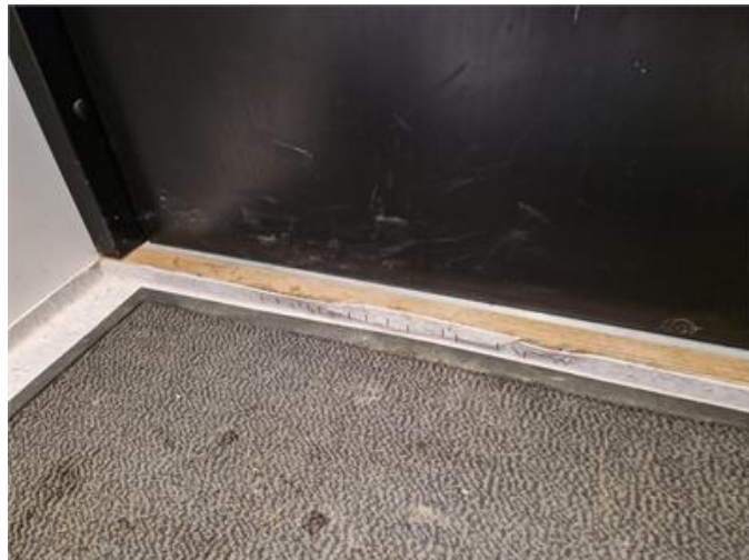
Tvättstuga: Matta har delvis lossnat i uppvik mot tröskel.
