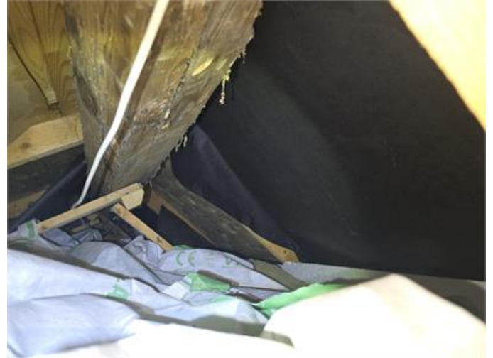
Nockvind: Översiktsbild från lucka.
