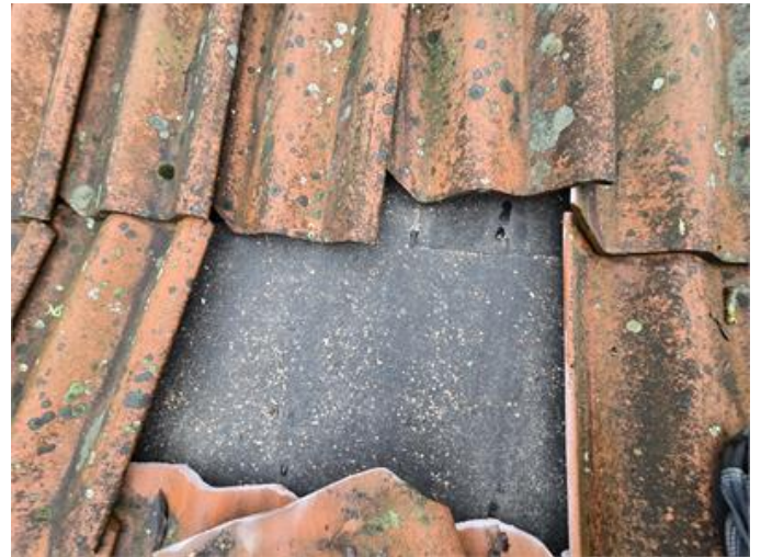
Tak: Stickprovskontroll under pannor vid takkupa, läkt finns ej.
