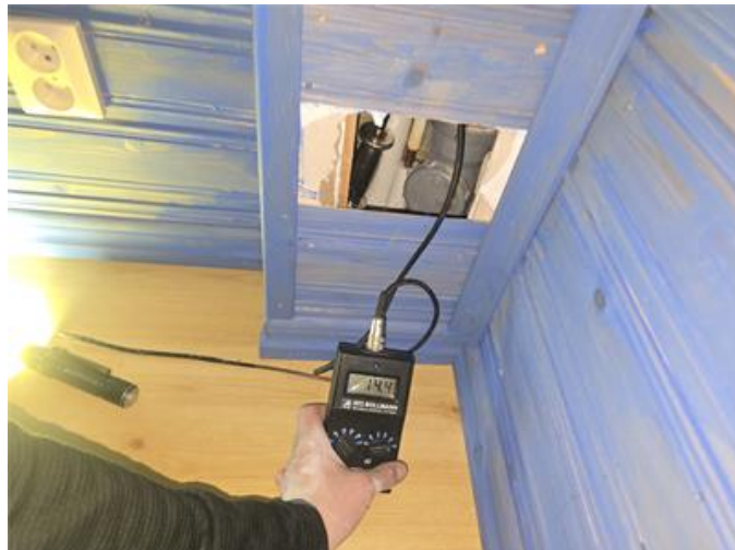
Fuktmätning i sovrum 3.
