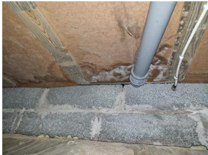
Krypgrund, fuktanvisningar efter läckage under Kök.
