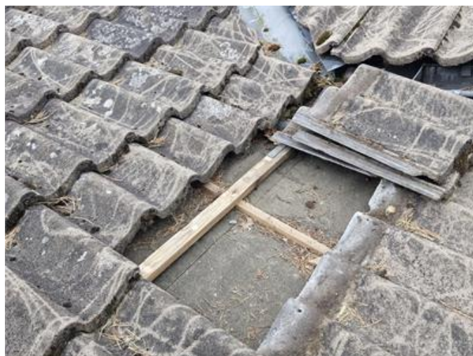
Tak, barr under pannorna och mossor vid rännar.
