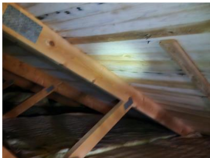
Nockvind sydöstra delen, mikrobiell påväxt i underlagstaket.
