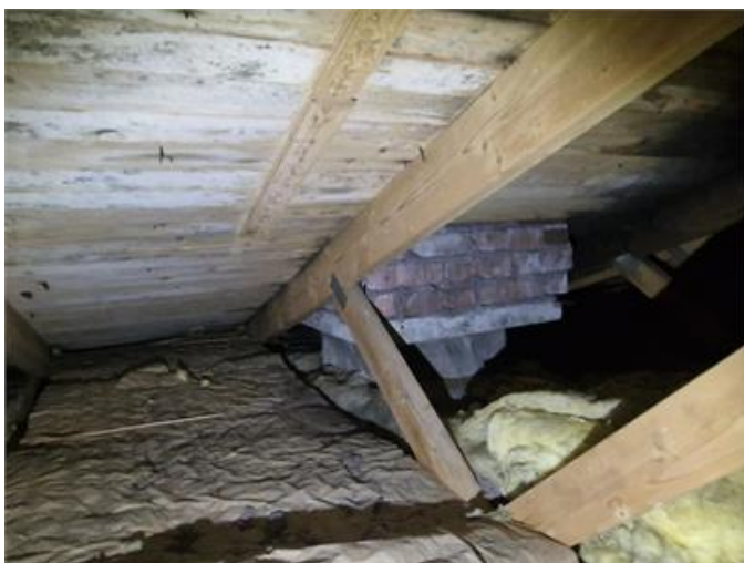
Nockvind nordvästra delen, mikrobiell påväxt i underlagstaket.
