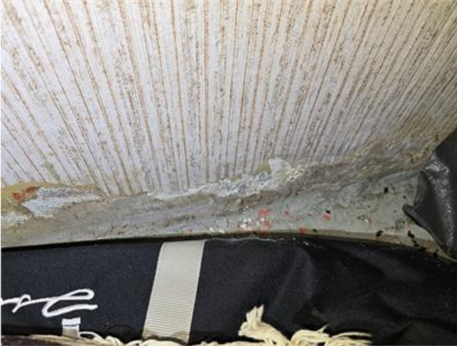
Källare: Fuktanvisningar noteras lokalt i grundmur.
