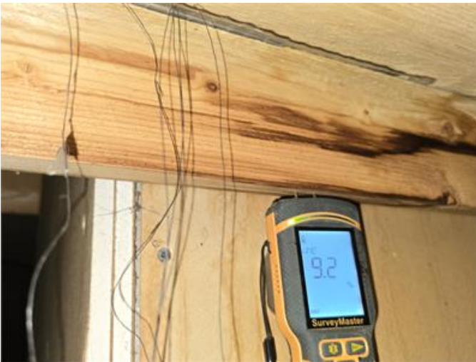
Nockvind: Missfärgningar i underlagstak nedan skorsten, torrt vid besiktning.
