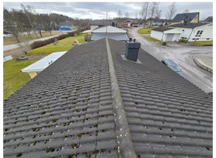
Tak: Översiktsbild, mossor bör avlägsnas.
