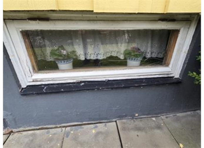
Fönster: Källarfönster med underhåll/renoveringsbehov, spricka noteras i glas.
