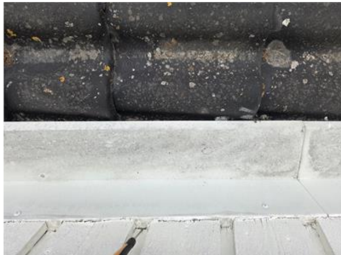
Anslutningsplåt mellan fasad och garage bör tätas.
