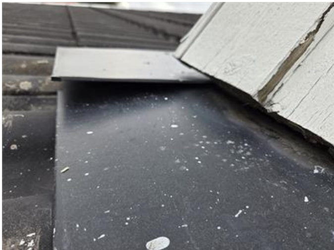
Otättheter på plåtdetaljer runt takkupa.
