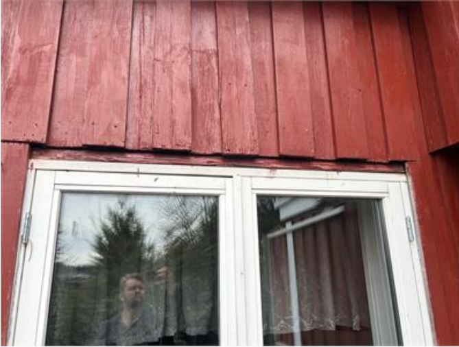
Exempel på fönsterdörr som inte har något plåtbleck.
