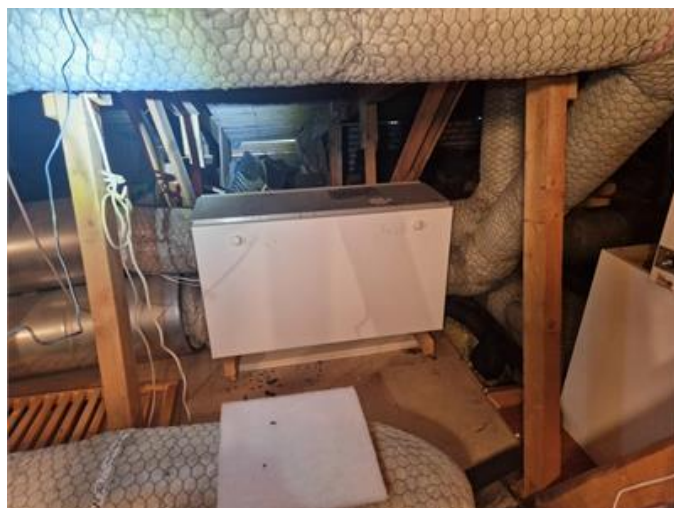
Vy på ventilationsaggregatet (FTX) på vindsutrymmet
