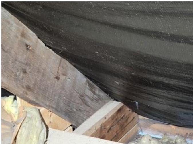
Fuktfläckar på takstolar
