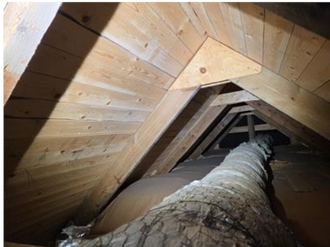
Mikrobiell påväxt på underlagstak.
