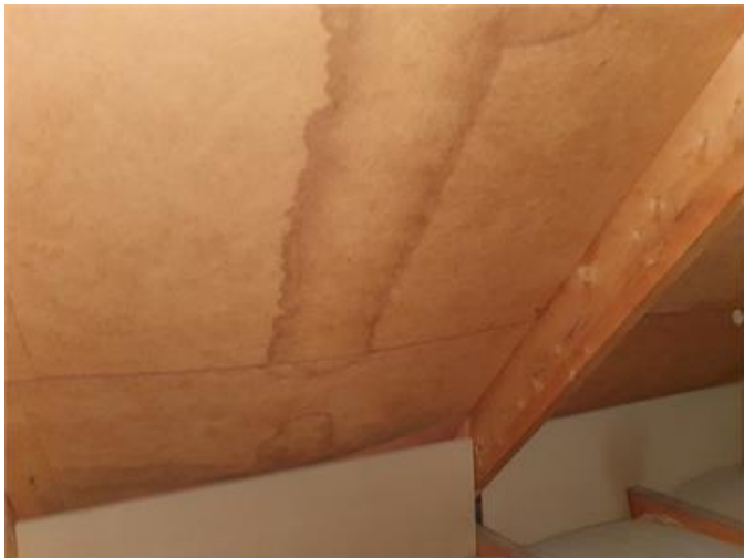
Sidovindar: Fuktfläckar förekommer på masonitskivor i underlagstak.
