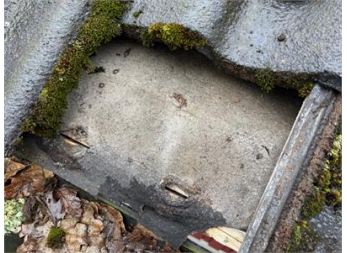
Bilden visar exempel på brister i taktäckningen.
