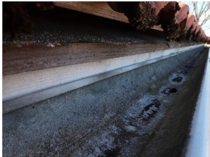
Takfotsplåt ej monterad.
