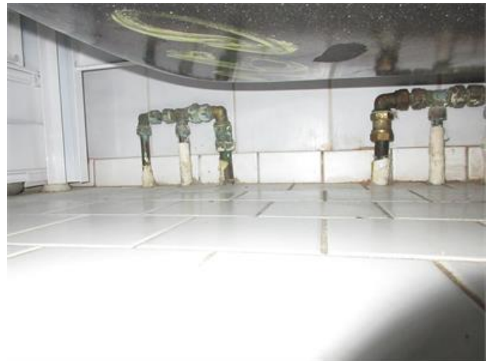
Rör genomföringar i golv i badrum samt klinkersockel som tandar mot kakelvägg
