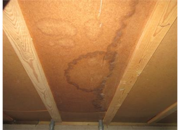
Exempel på missfärgningar undersida bjälklag i krypgrund
