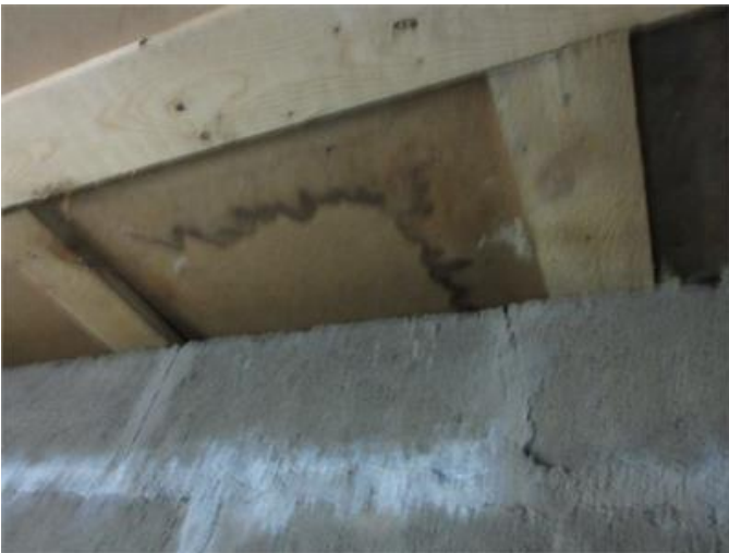
Exempel på missfärgningar undersida bjälklag i krypgrund
