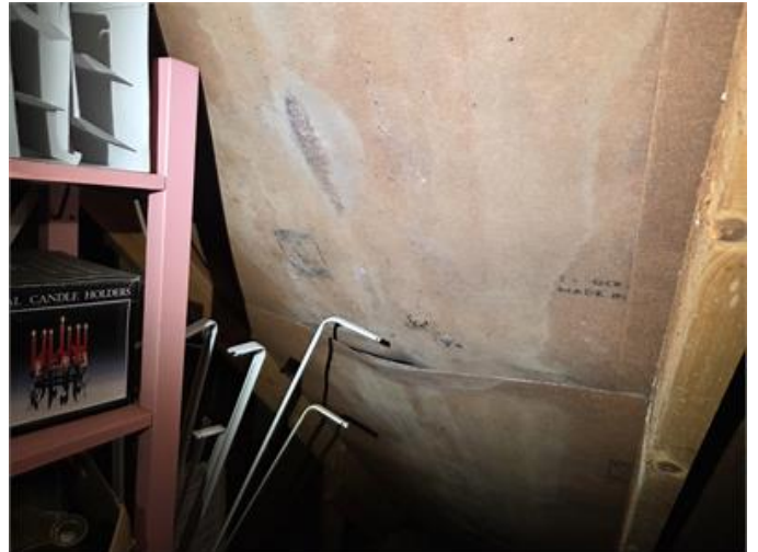
Fuktfläckar samt mikrobiell påväxt.
