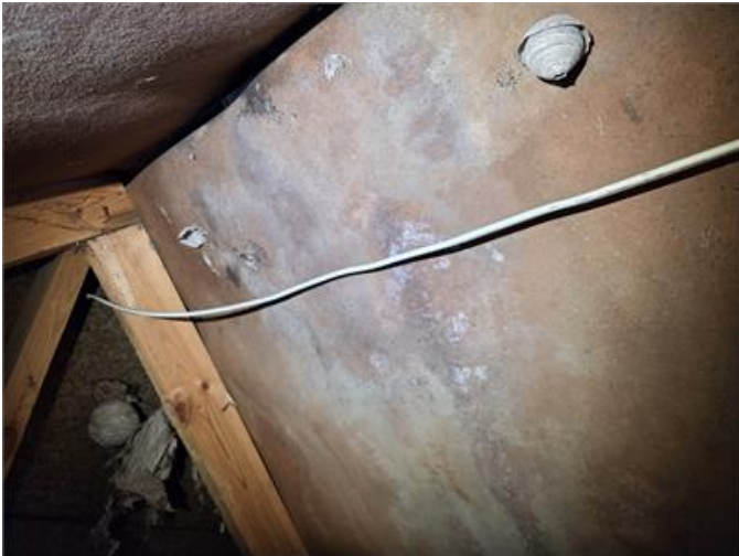
Fuktfläckar samt mikrobiell påväxt.
