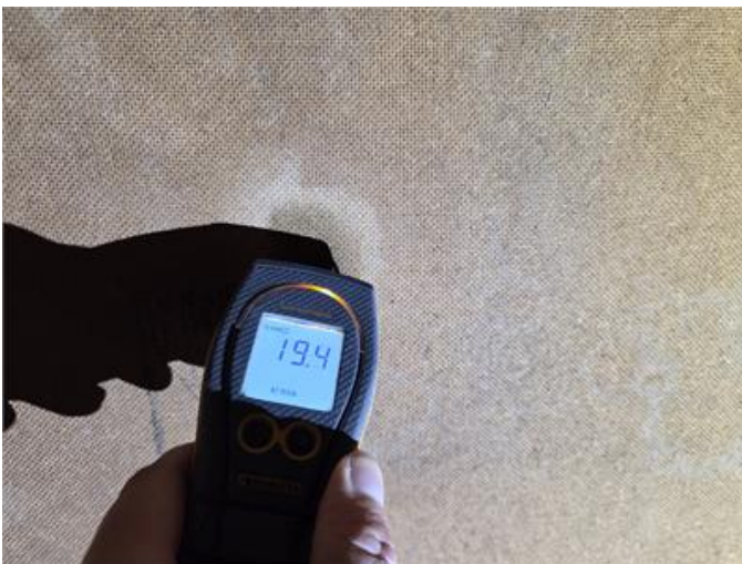
Läckage i yttertak.
