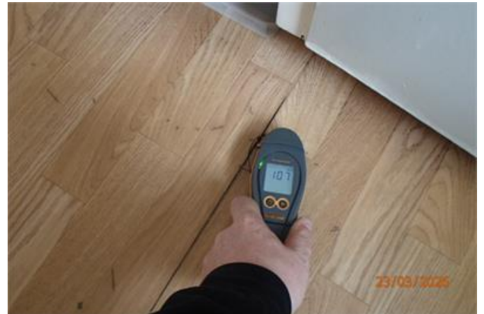
Fuktskadad golv i köket.
