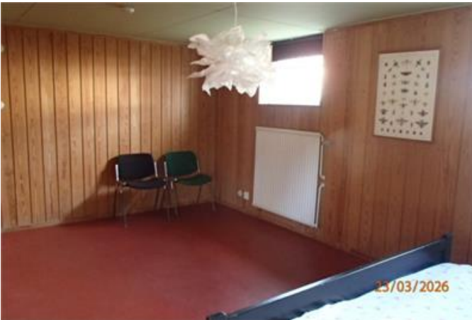
Utreglade väggar noterad i gästrummet i källaren. Se bilaga kontroll av konstruktion
