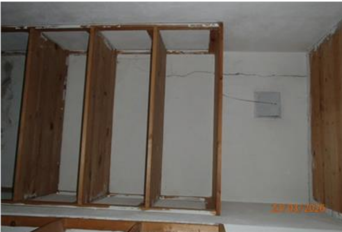
Spricka i källarväggen / matförrådet.
