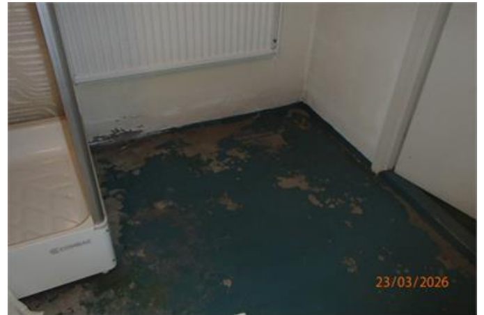
Färg släpp på golv samt lös puts på källarväggar noterad.
