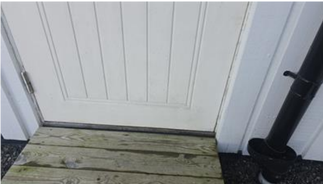
Exempelbild, målning/underhållsbehov dörr och avsaknad av tröskelbleck.
