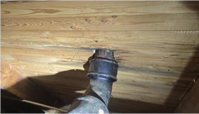
Exempelbild, fuktfläck i underlagstak kring genomföring, vind.
