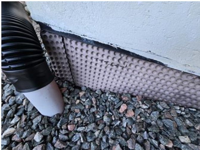
Sockel: Fuktskydd synligt ovan mark samt har skador/otätheter.
