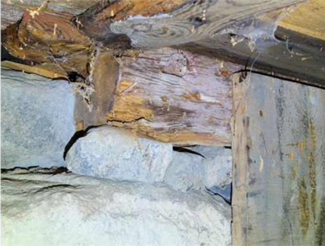
Torpargrund: Lokala mindre rötskador noterades.
