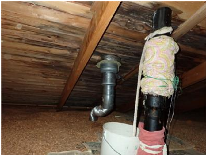
Exempel på fuktpåverkan på underlagstak vind.
