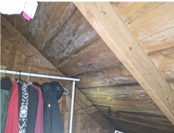
Nockvind, mikrobiella missfärgningar i underlagstaket.
