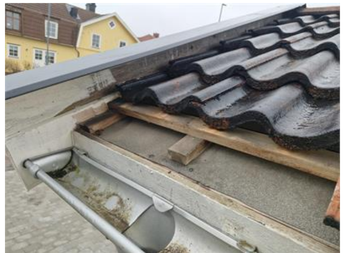
Tak Garage, stort avstånd mellan vattplåt och pannor, underlagspappen täcker ej takfotsbrädan.
