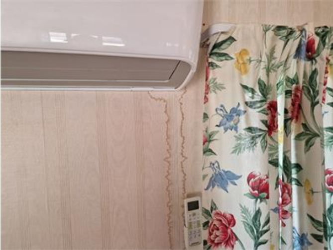
Allrum: Fuktfläckar förekommer på vägg vid luft/luftvärmepumpens inomhusdel.
