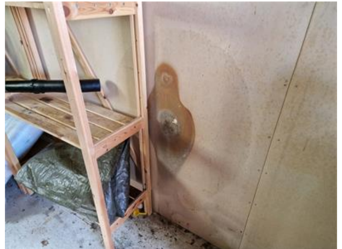
Garage: Missfärgning noterades på innervägg
