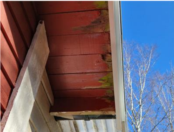
Tak: Skador noterades i takfot.
