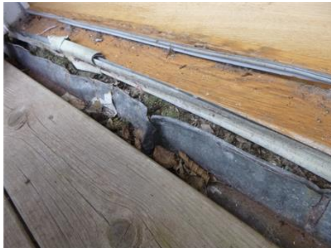
Otätt uppvik av balkongens plåtning mot dörrpost
