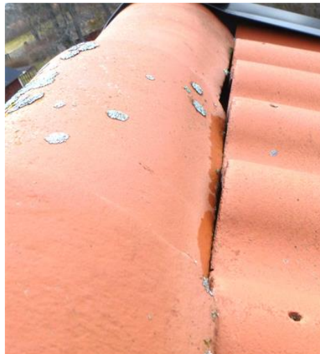
Nockpannor överlappar inte mot takpannor
