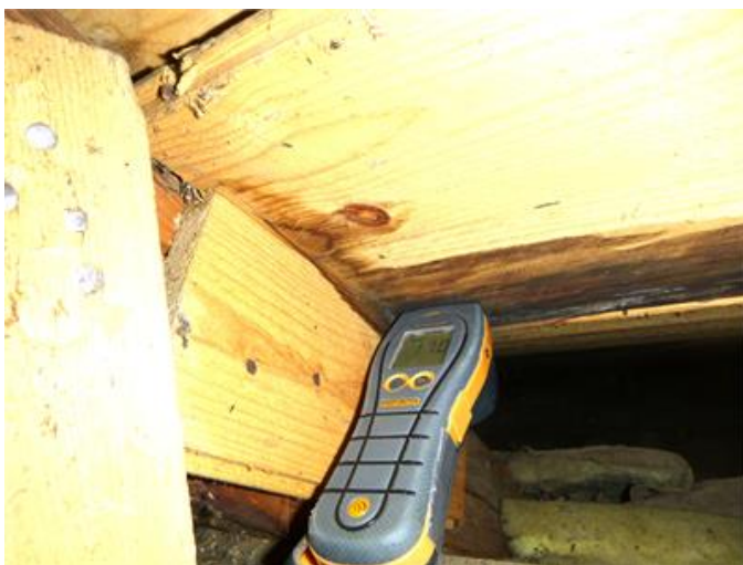
Läckage på insida yttertak under takkupa
