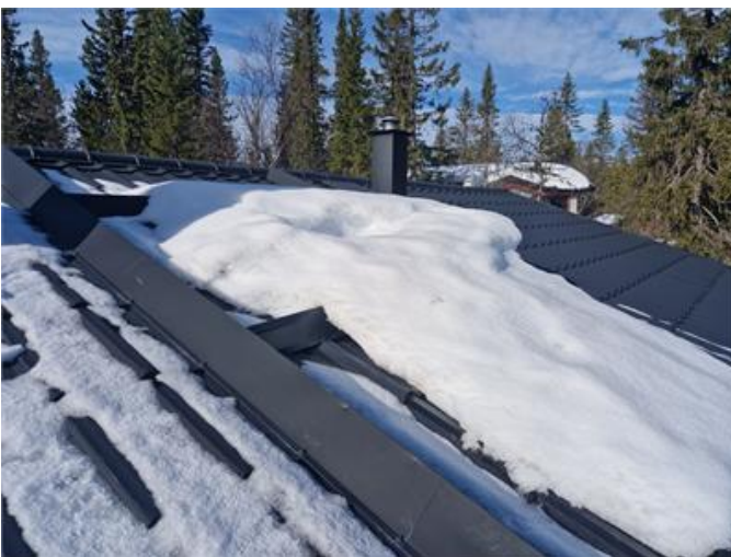
Delar av tak är snötäckt och kan ej bedömas,
