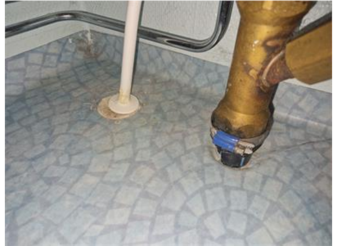
Tätningar runt rörgenomföringar bör förbättras.
