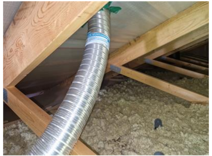
Vind, ventilation/frånluft är oisolerad.
