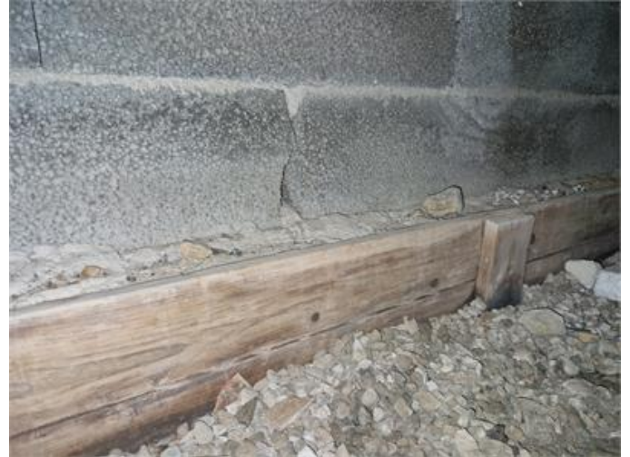
Ursprungligt golvbjälklag bedöms dock vara kvar utan synligt tecken på åtgärd, viss mikrobiell påväxt noteras.
