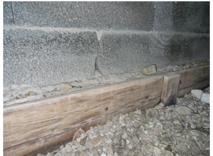
Krypgrund under förråd omfattas ej av avfuktaren. Formvirke bör rensas ut och mark täckas med plast, samt att lucka hållas öppen mellan grunderna.
