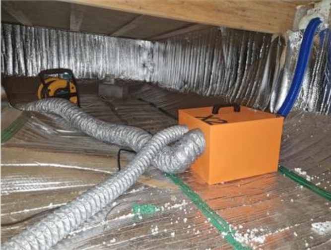
Krypgrund med avfuktare
