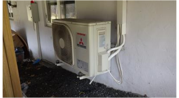
Värmepumpens utomhusdel monterad på huslivet
