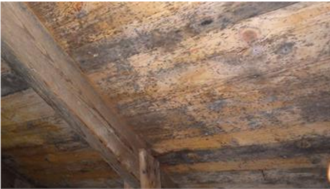
Mikrobiell påväxt på insida yttertaket på vinden
