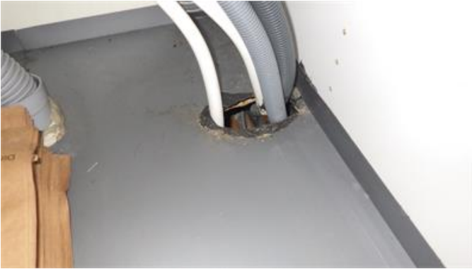
Otätt mellan rör och fuktskydd i diskbänksskåpet
