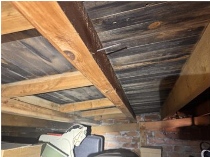
Bild visar mikrobiell påväxt mot underlagstak.
