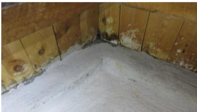
Missfärgning i anslutning till murstock på nockvind.
