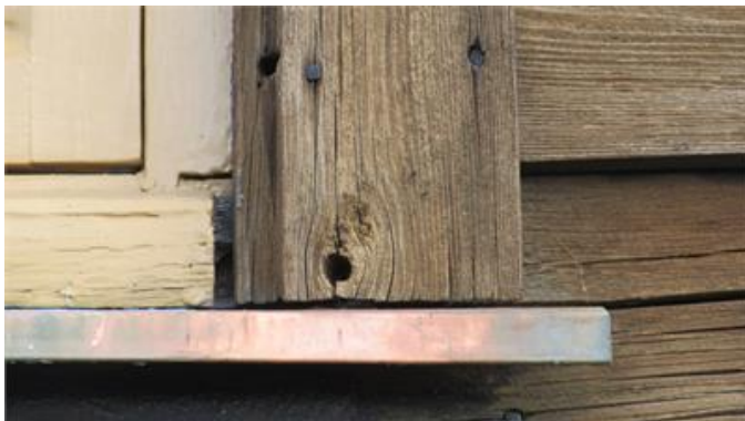
Otättheter bleck/infästning fönster.
