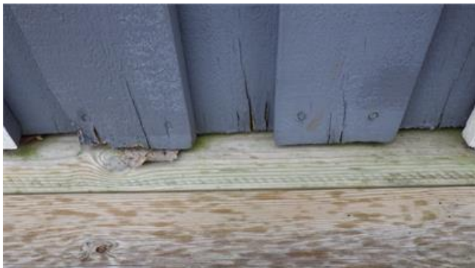
Rötskada i nederkant fasadpanel
