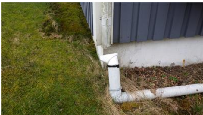
Stuprör som inte är kopplat till dagvattenledning
