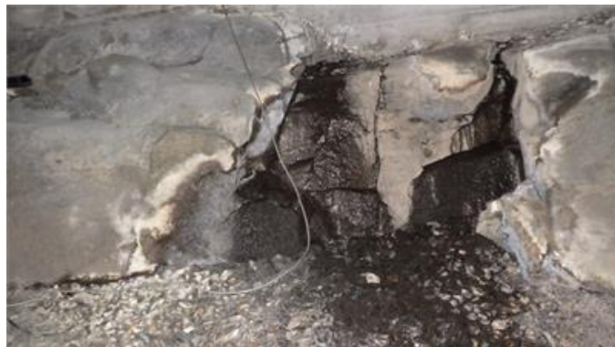
Vatteninträngning i kryppgrunden
