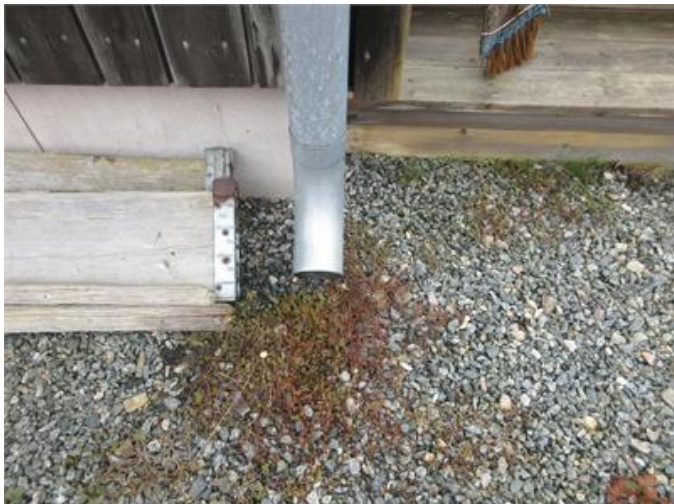
Stuprör släpper regnvatten intill hus
