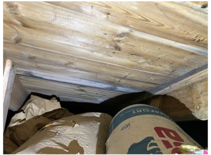
Nockvind: Mikrobiell påväxt noteras på underlagstaket.
