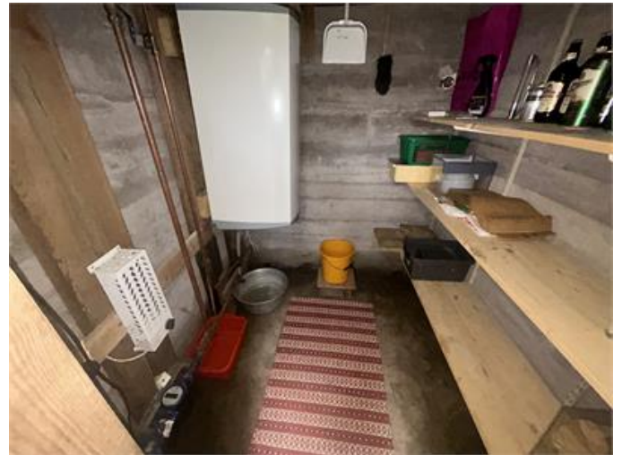
Källare: Översiktsbild med synlig fuktanvisning i grundmuren.
