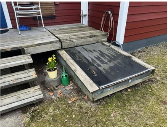
Källarlucka: Regnvatten kommer ner till källaren pga otät lucka.
