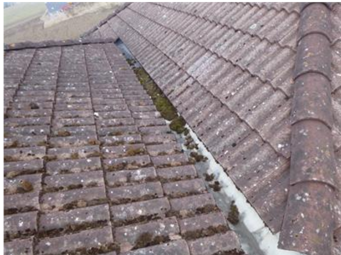
Mossa på takpannor och delvis igensatt låglutande vinkelränna
