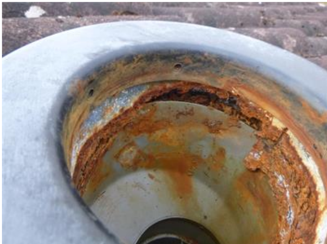
Korrosion i avloppsluftning
