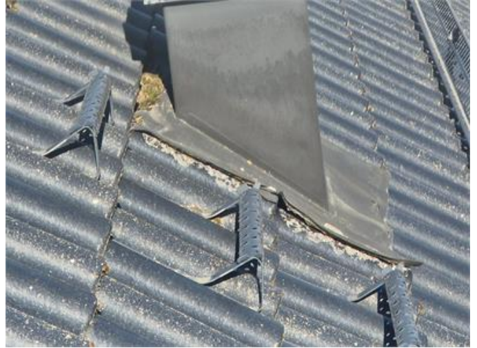
Bristfälligt mellan takpannor och plåthuv
