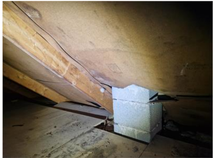
Lokala fuktfläckar på underlagstak
