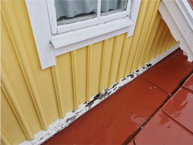
Fasad och Fönster, rötskador södersidan.
