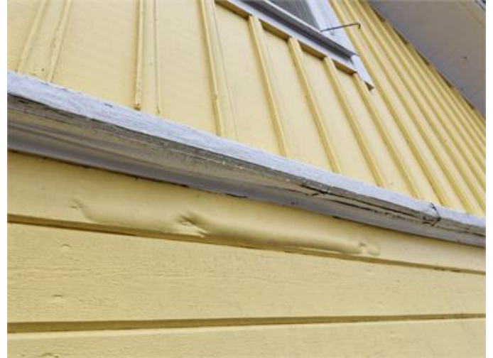
Fasad, rötskador östra gaveln.
