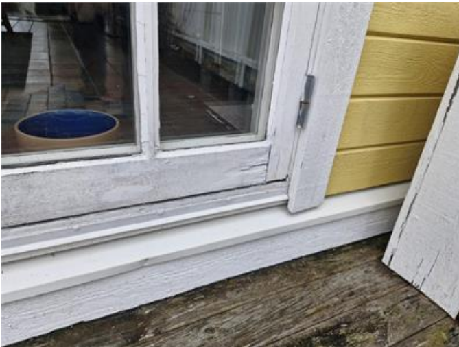
Dörrar, rötskador nederkant altandörr.
