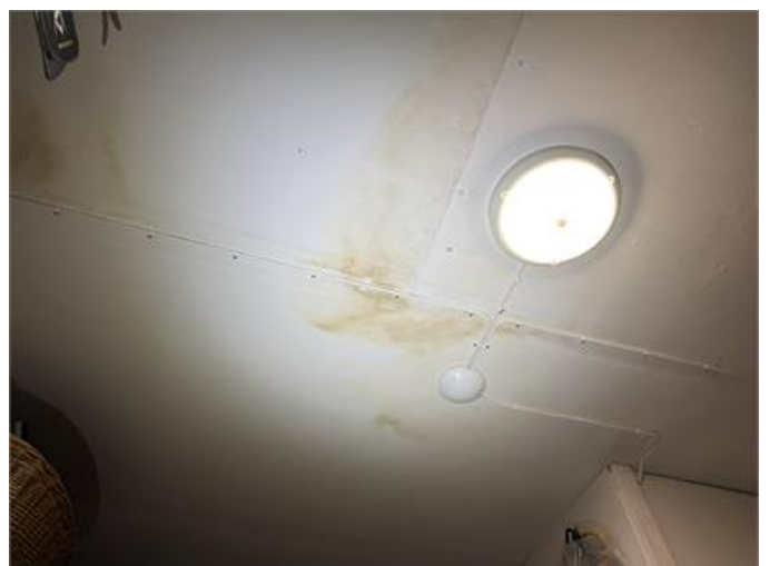
Fuktfläck/missfärgning i tak förråd (inga avvikande värden)
