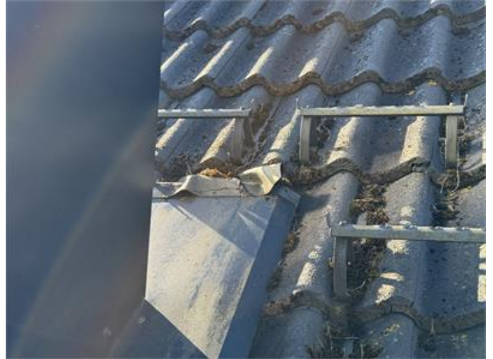
Otätthet vid skorstensbeslag
