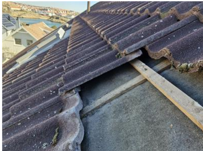
Tak, åldersslitage på underlagspapp och läkt.
