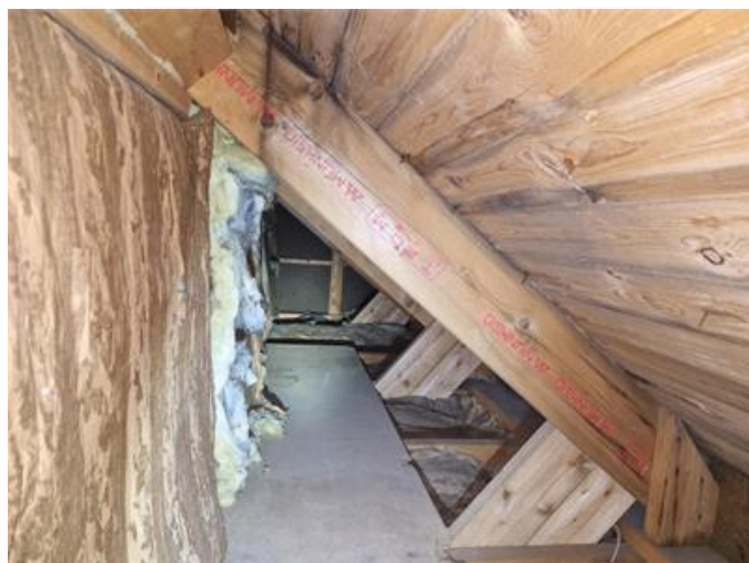
Sidovind sydost, torra fuktanvisningar i tak och golvytan.
