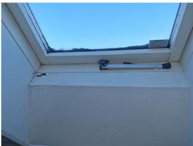
Takfönster, äldre med kondens, mikrobiell påväxt i karm samt färgsläpp smygar.
