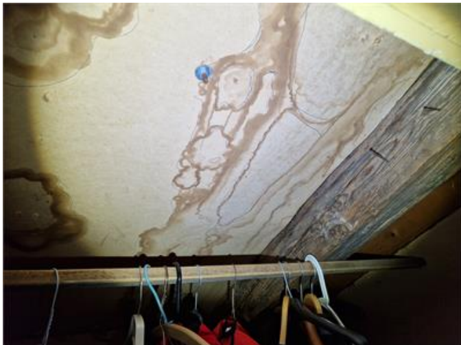
Sidovind 1: Äldre fuktfläckar förekommer i tak.
