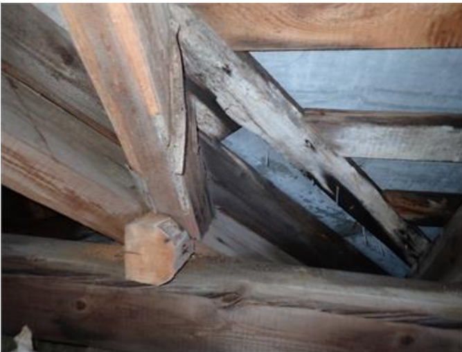
Exempel på mikrobiell påväxt på vind.
