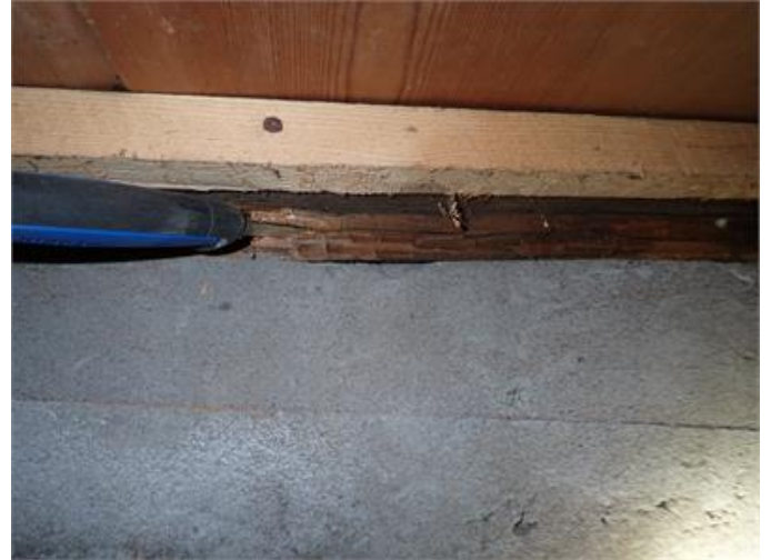
Exempel på rötskadad bottenstock i torpargrund.
