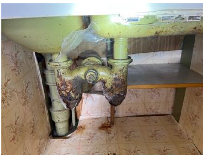
El/vvs och ventiltion är av äldre datum och i behov av översyn/åtgärder.
