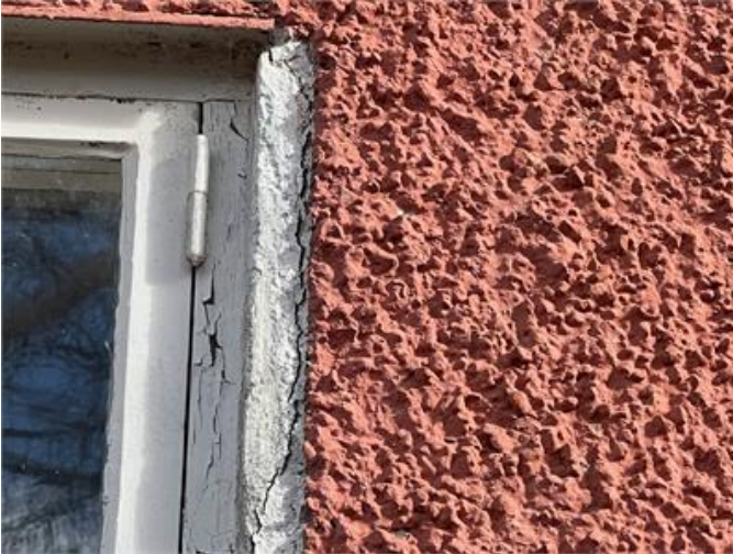
Exempel på sprickor i fasaden.
