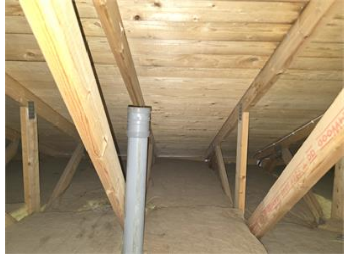
Exempel från vinden och avloppsventilation.
