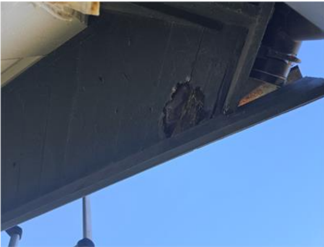
Skada i yttertak.
