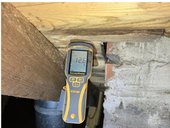
Nockvind: Fuktfläckar runt murstock, fuktkvotsmätning utförd utan anmärkning.
