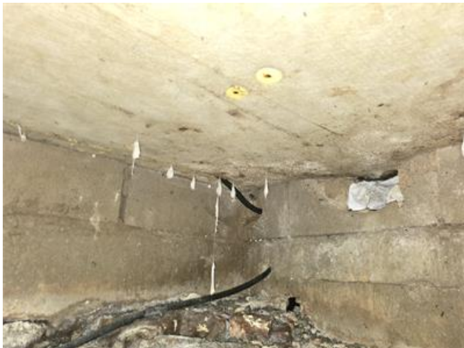
Krypgrund: Mikrobiell påväxt på isolering (blindbotten).
