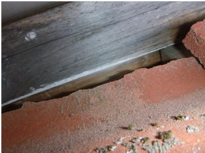
Bristfälligt uppvik på takpannor under ena vindplåten
