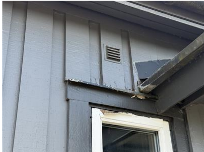
Rötskador noterades lokalt på fasadpanelen.
