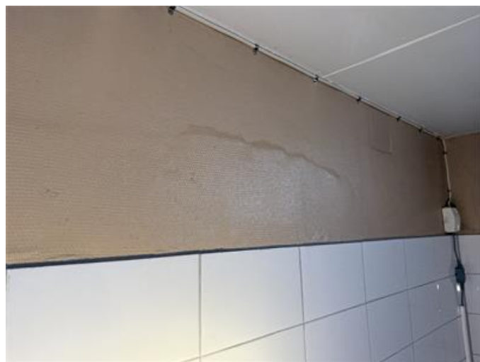
Putssläpp förekommer från källaryttväggarna (vävtapeten har lokalt släpp från underlaget).
