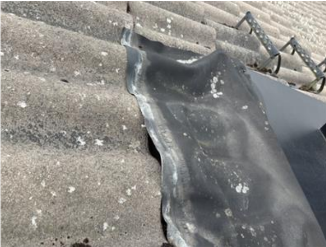
Bilden visar skorstens detalj som är i behov av justering.
