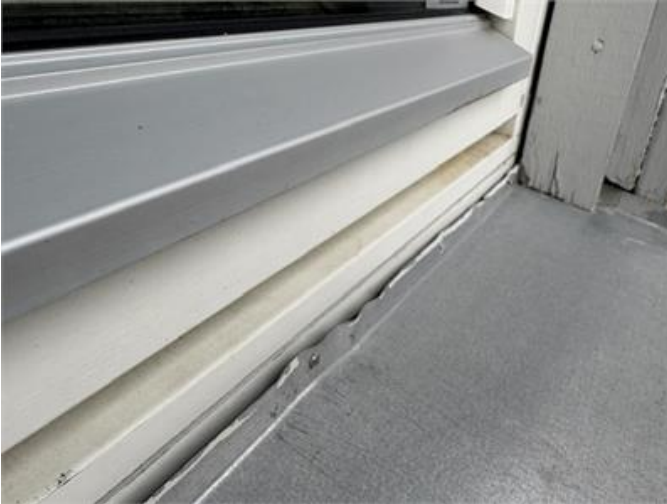
Bilden visar exempel på otätheter/brister vid/med plåtdetalj.
