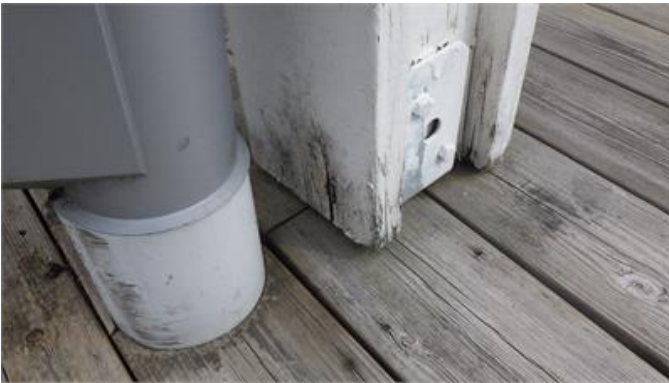
Rötskada i stolpe till uteplatsen
