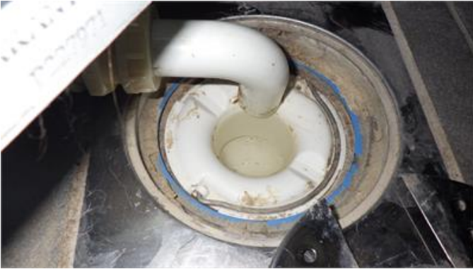
Golvbrunn utan synlig brunnsmanschett
