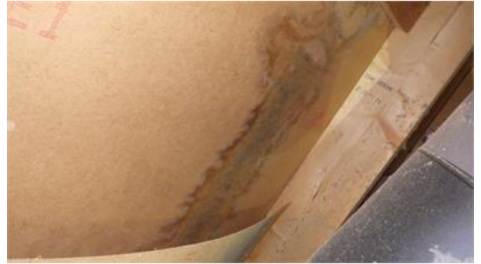
Fuktfläck på träfiberskivorna på vinden
