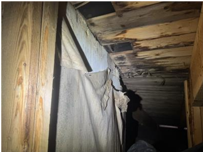
Fuktskador runt skorsten/ventilation på framsidan.
