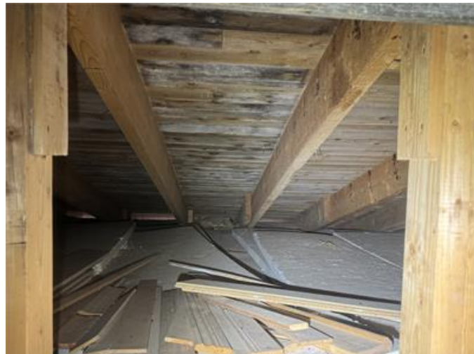
Bilden visar mikrobiell påväxt på takets undersida.
